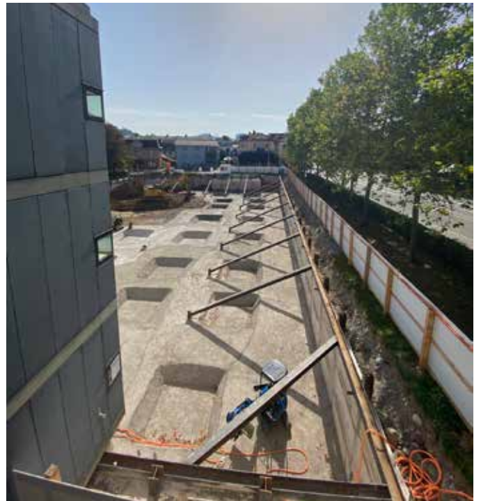
Die Rühlwände für die Tiefgarage sind errichtet. Sie dienen der temporären Baugrubensicherung.
